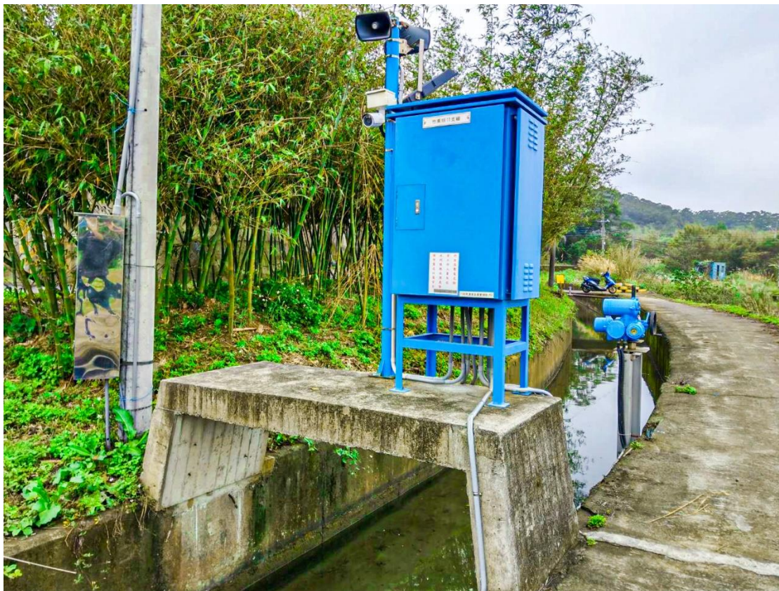
圖 1、水閘門遠端遙控系統
