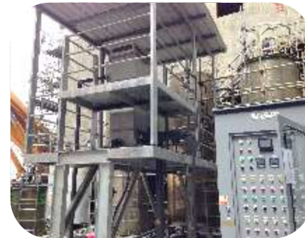
台灣電力公司林口電廠 LINKOU TAIWAN POWER COMPANY 200 CMD
